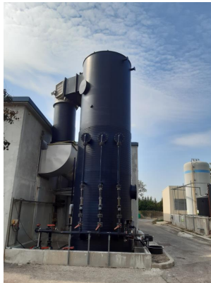
Tour de lavage acide
