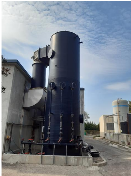
tour de lavage de l'air vicié
